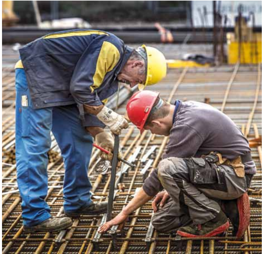
Am Areal wird fleißig und präzise gearbeitet, damit das Projekt im Zeitplan bleibt.
