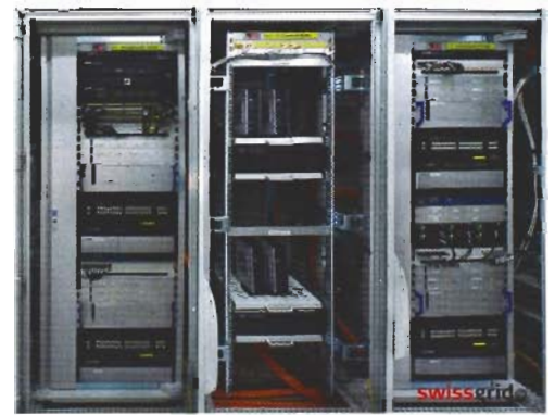
Schaltschränke für die AV-Technik
