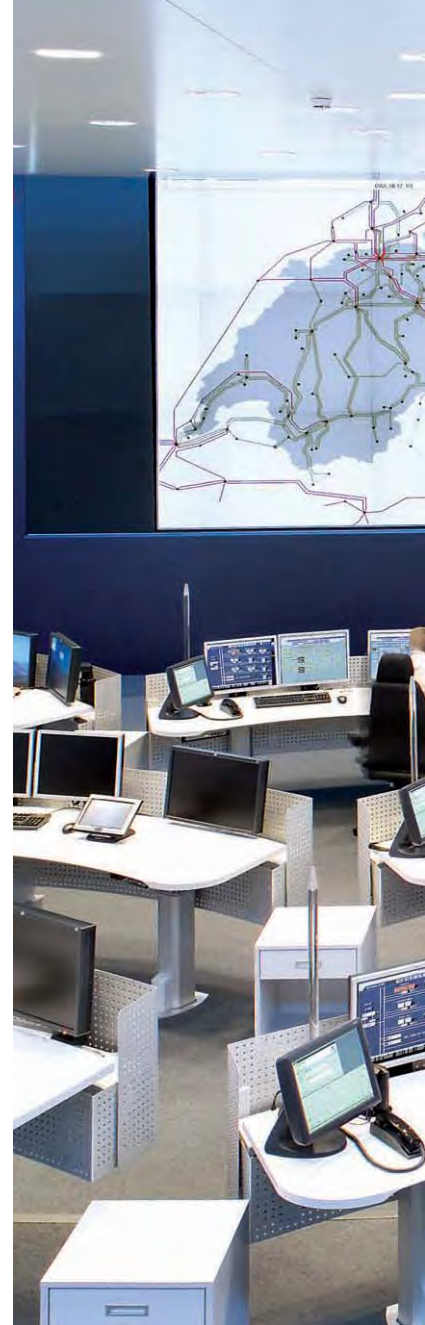
Die Drehscheibe: «Swissgrid Control» heisst die moderne Schaltzentrale in Laufenburg.
