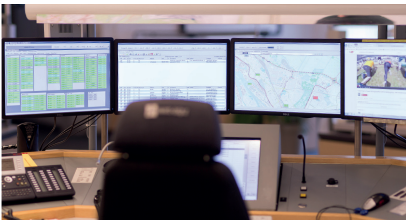
Abb. 4: Jedes System bzw. jede Technologie hat technische und kommerzielle Vor- und Nachteile, die in Nutzwertanalysen projektspezifisch beurteilt werden müssen.
