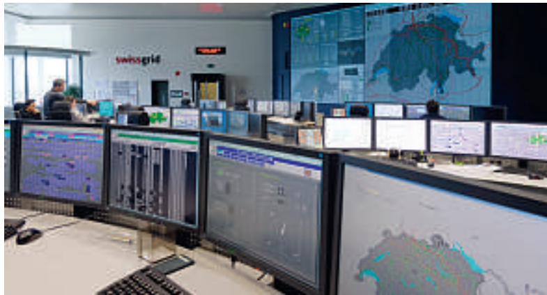
Die Netzleitstelle von Swissgrid überwacht und steuert das Höchstspannungsnetz der Schweiz. (Bilder: Siemens)
